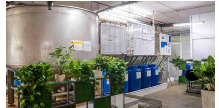
Hệ thống xử lý nước thải tại nhà máy PNJ
